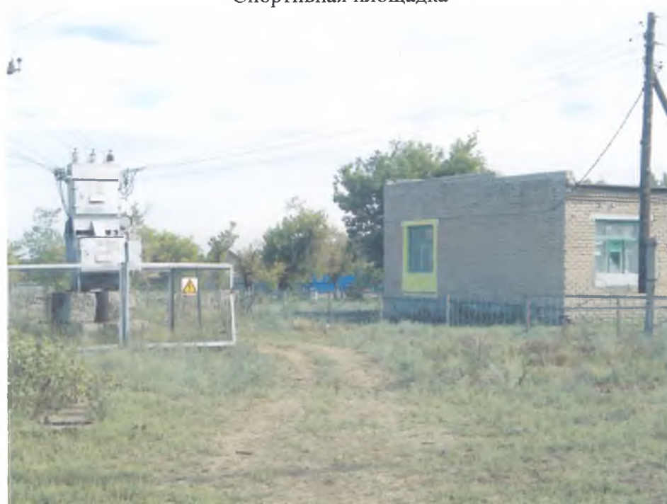
Место расположения трансформатора
